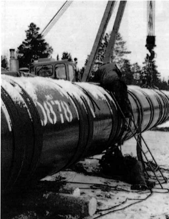
Илл. 3 — Монтажная сварка на строительстве трубопровода в России, где электроды FAMILIARC™ LB-52U используются для сварки кольцевых швов в морозных условиях.
